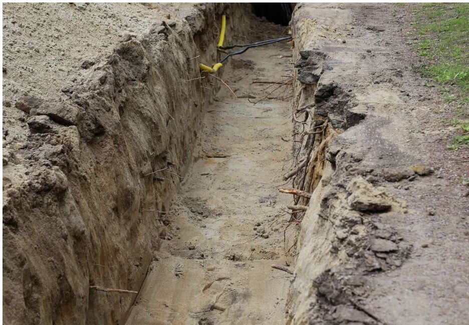
Korrekt beskurna rötter i kabelgrav.
